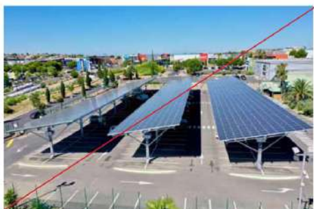
Ombrières sur zone de stationnement - A EVITER
